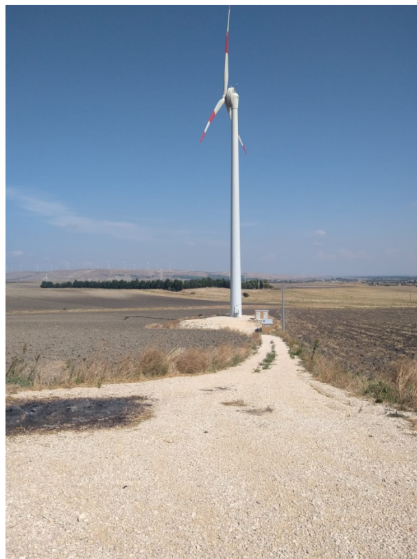
FOTO 2 – macchina eolica EWT DW da 500 KW (cioè mezzo MW). Altezza al mozzo 50, 70 m più 30,5 m di diametro, agro di Troia (Fg). Si noti la porta di accesso alla base della torre per inquadrare le dimensioni della macchina
